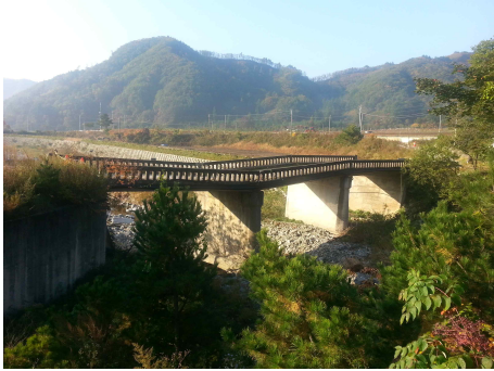
(a) 세굴심에 의한 교량침하(번천교)
