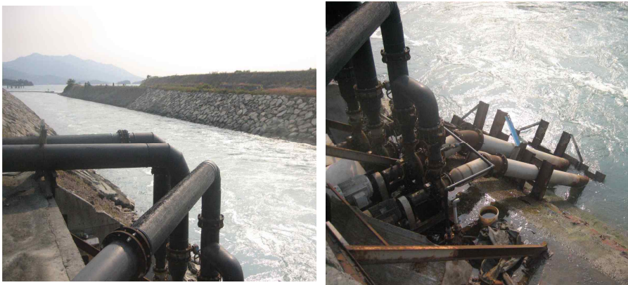
〈그림 Ⅲ-6〉 하동 화력발전소 온배수 취수 배관의 모습.
