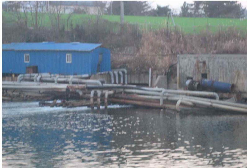
〈그림 III-8〉 영동화력발전소 온배수 취수 배관.
