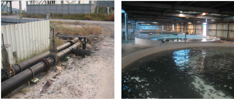
〈그림 III-7〉 하동화력발전소 온배수 배관 및 양식 수조.
