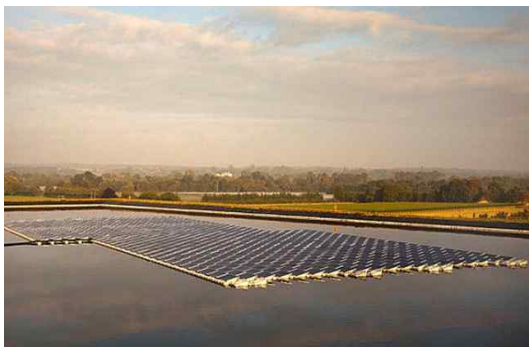
(e) 홍수조절지의 부유식 태양광 발전
