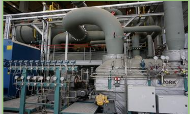
오스트리아 빈의 하수이용 히트펌프(55MW)
